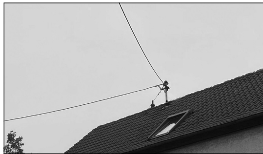
Sieht aus wie ein Provisorium, bleibt aber erstmal so: Stromversorgung via Freileitung.
