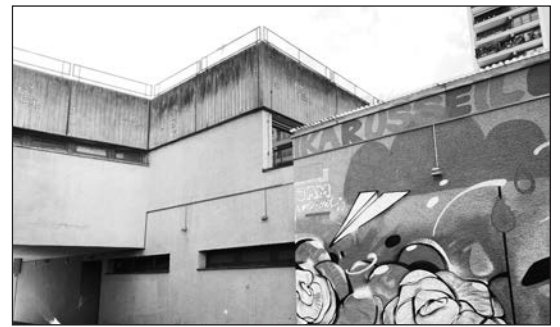
DER SANIERUNGSRÜCKSTAU des 50 Jahre alten Gebäudes ist allgegenwärtig. Foto: rsp
